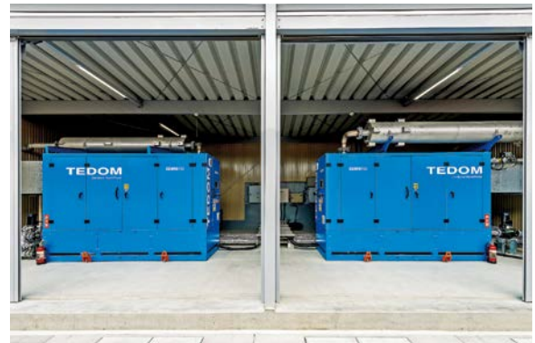
写真-1 ガスエンジン発電機（85 kw × 2台）
