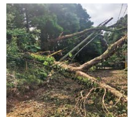
倒木による電柱倒壊（四街道市）
