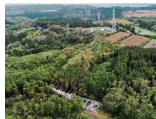
鉄塔設備の倒壊（君津市）
