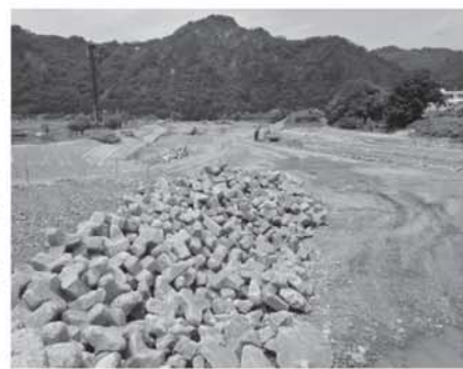
▲河川環境を考慮しない河川工事
