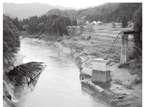
▲鉄橋が落ちた只見線(金山町)
