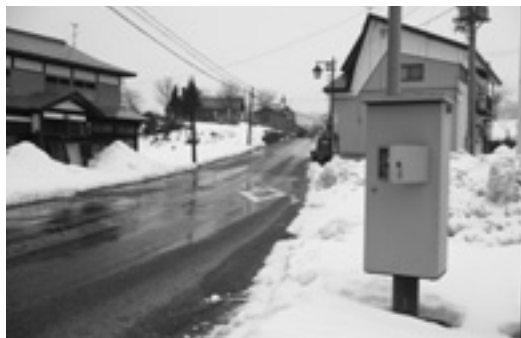
福井にある消雪パイプの操作盤
