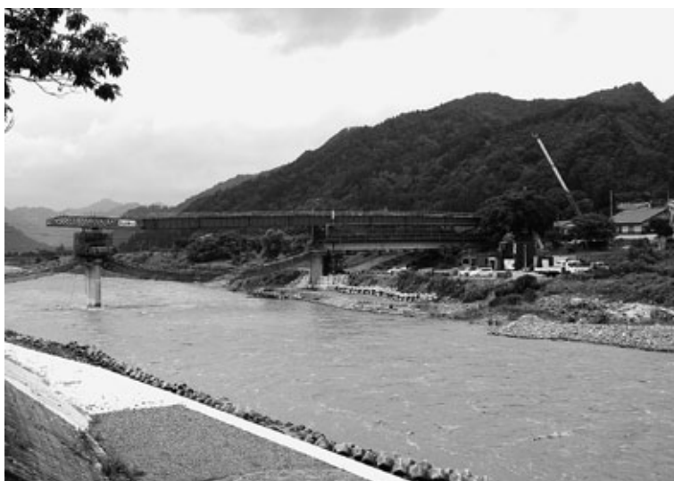
豪雨災害からの復興はなかなか進まない（小川橋の工事現場）
