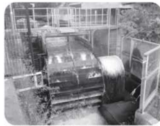
研修で視察した小水力発電施設
